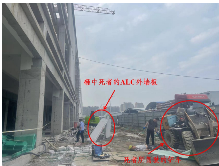
图1 事故现场照片
